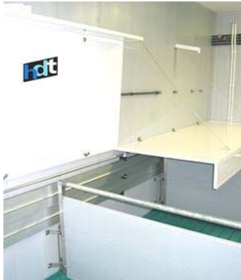
Bild 8: Zonenheizung mit Warmwasser
